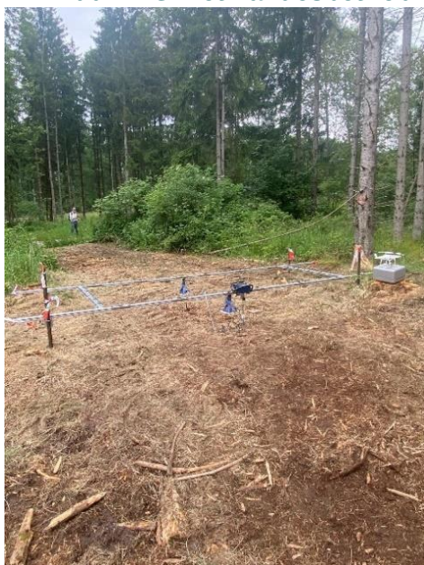
Figure 1 : Châssis métallique installé sur les voies de vidange
