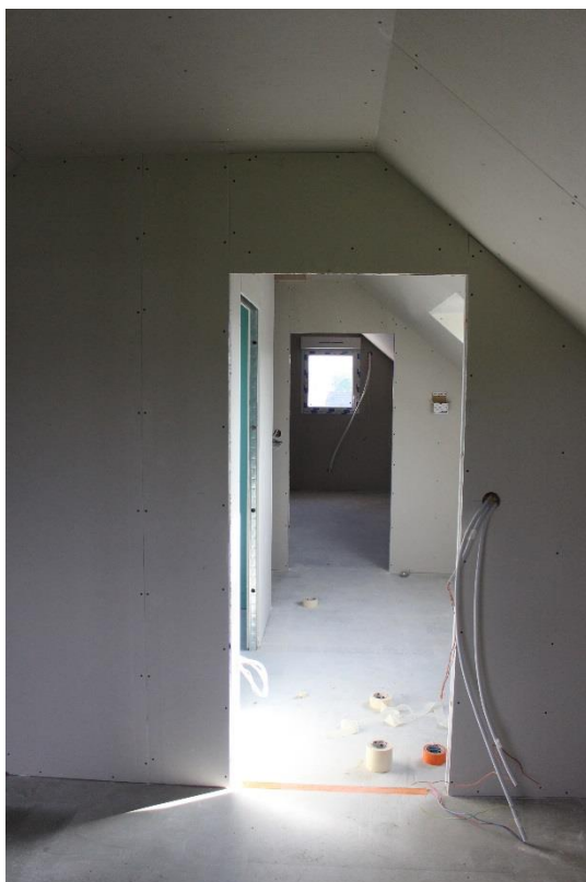
Figure 114 - Plancher lors de la phase 2
