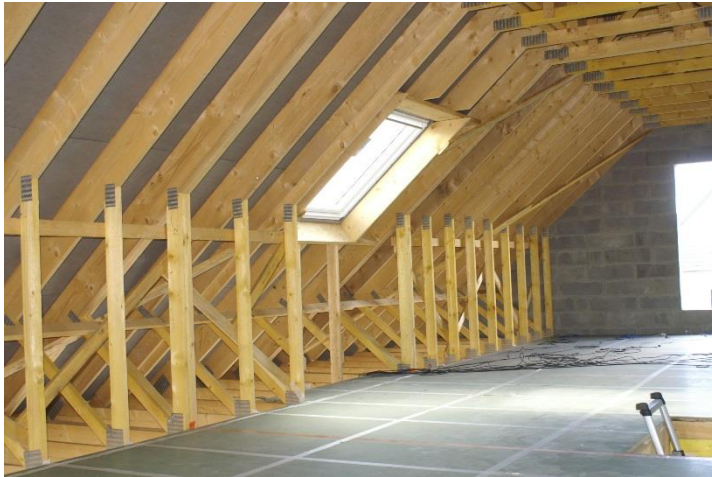
Figure 113 - Plancher lors de la phase 1
